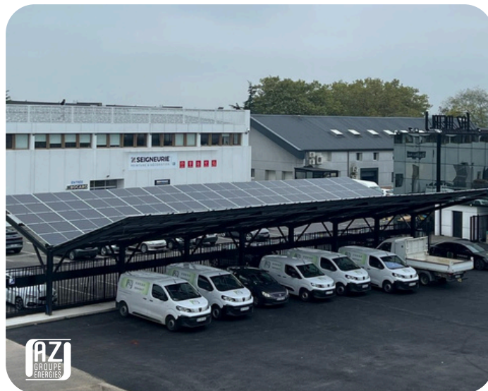
Installation solaire sur carport / ombrière du parking - Parking d'AZ Groupe Energies
