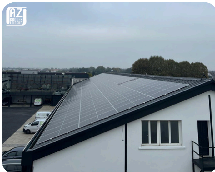
Notre installation solaire sur le parking AZ Groupe Energies
