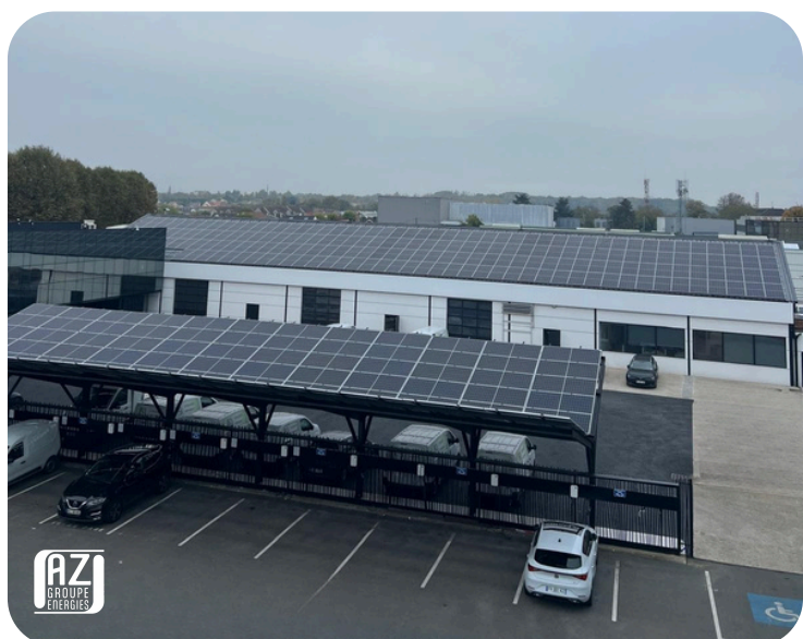
Notre installation solaire sur le parking AZ Groupe Energies
